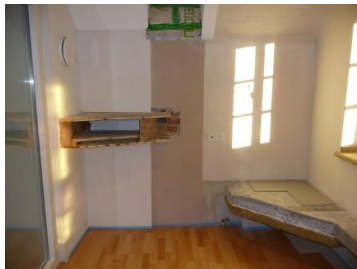
Geschossdecken durchbrechen die Innendämmung.
